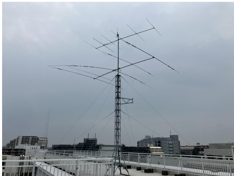
東10号館のアンテナ鉄塔
