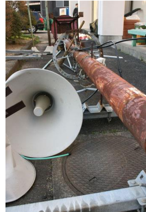
3月11日の地震で倒れた 防災無線アンテナ
