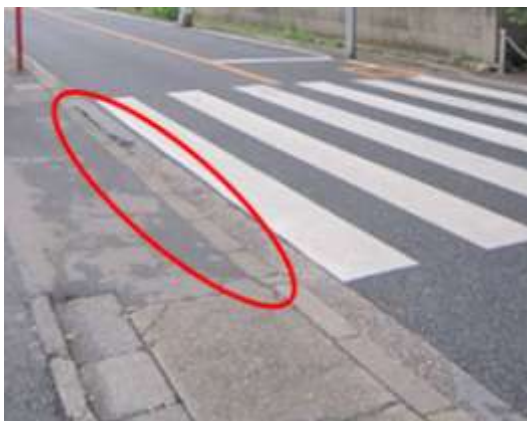
図2-7: 歩道と車道の段差
