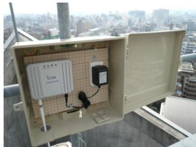
▲総合研究棟に設置したレピータ装置
